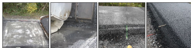
Bild 2: Auswahl an künstlich hergestellten Substanzschädigungen auf der Versuchsstrecke
