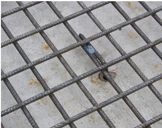
Bild 5: Mit Stahldübeln an der Tragschicht verankerte Bewehrung in Betonierabschnitten II und III
